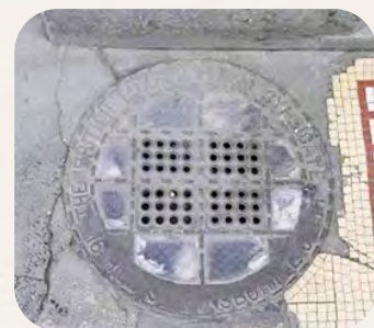
倫敦街道上現存的維多利亞時期天窗（圖片由Luxcrete公司提供）
